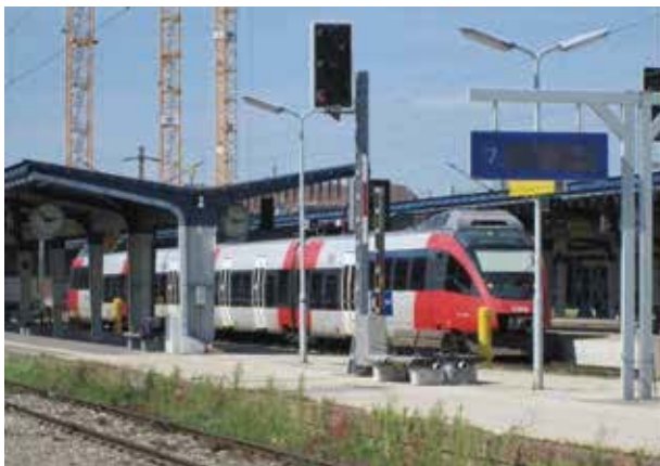
圖二 改建中的奧地利維也納南站。本站曾經是奧匈帝國最大的鐵道車站，為南部鐵道與東部鐵道的始發站，採用終端式的軌道與月臺配置。2009年開始原址改建成維也納中央車站並改用通過式的配置。月臺後面黃色塔式吊車的位置為施工區域。
